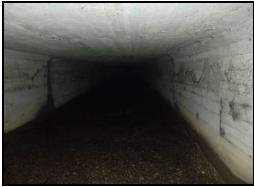
Effet tunnel interdisant l'utilisation de l'ouvrage (crédit photo : C. Gilles).
