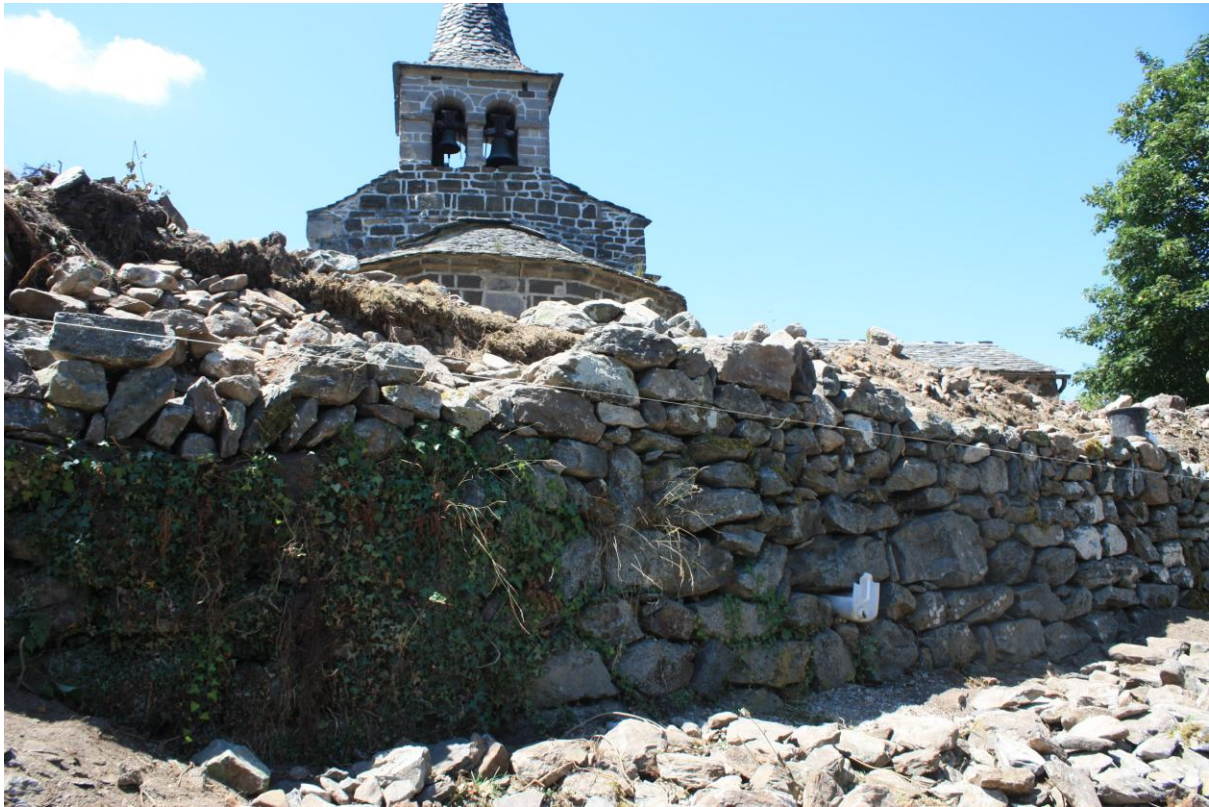
Figure 2.15 - Aménagement d'un muret de soutènement devant l'église de la commune de Bessamorel réalisé par des murailleurs professionnels - Juillet 2018
