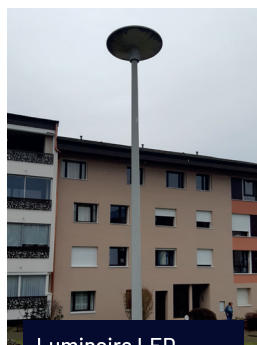
Luminaire LED Détection de présence
