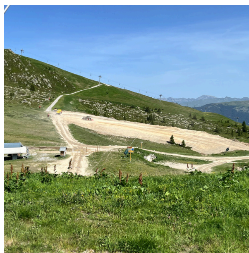
Déblais de déchets à Courchevel © Jean Kerrien
